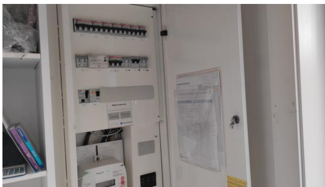
El-skap for 1. og 2. etasjen.
