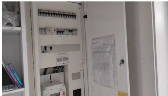
El-skap for 1. og 2. etasjen.
