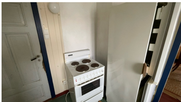
Det er ikke montert avtrekk.
