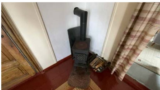
Montert ovn i stue.
