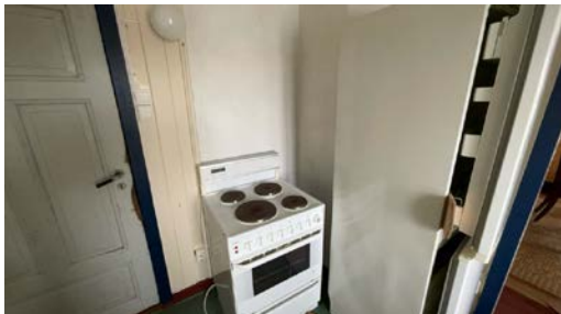
Det er ikke montert avtrekk.
