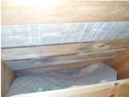
Ingen luftespalte i mellom isolasjon og undertak
