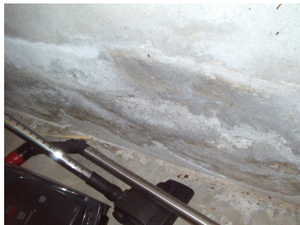
Fuktvandring og saltutslag i nedre del av grunnmur.
