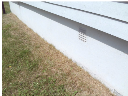
Bra med ventiler i ringmur.
