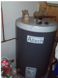
Bereder er plassert på vaskerommet
