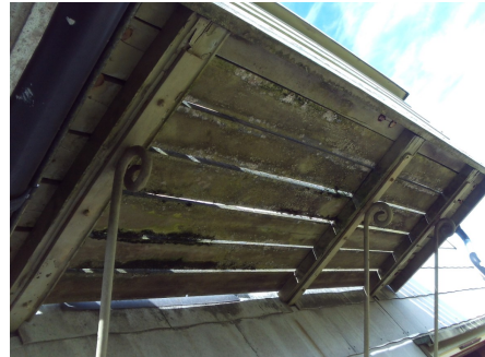
Luftebalkong er slitt.
