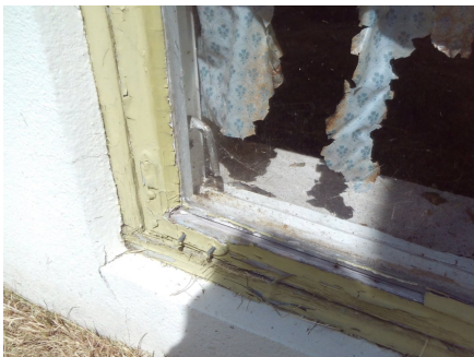
Eldre slitte/skadet kjellervinduer.
