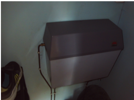
Dagtank med røropplegg
