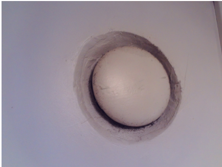
Ventil til luftekanal i pipe.
