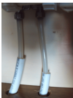
Vannrør i kjøkkenbenken uten muffe.
