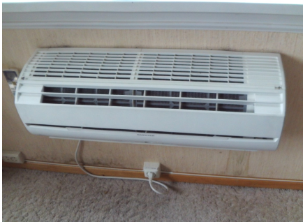
Varmepumpe i stue.
