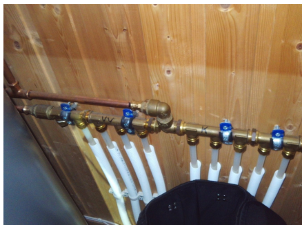
Åpne koblinger på vaskerommet
