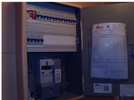
Sikringsskapet er plassert i gangen på loftet.
