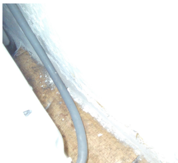
Murvegger med noe fuktighet
