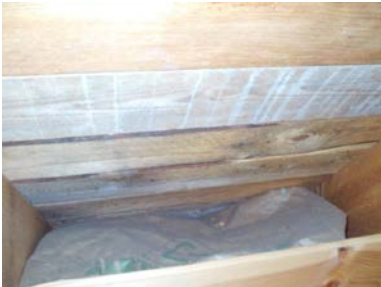
Ingen luftespalte i mellom isolasjon og undertak
