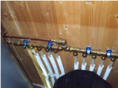
Åpne koblinger på vaskerommet
