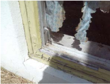
Eldre slitte/skadet kjellervinduer.
