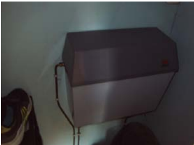
Dagtank med røropplegg
