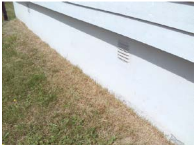
Bra med ventiler i ringmur.
