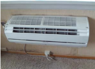
Varmepumpe i stue.
