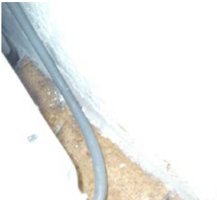
Murvegger med noe fuktighet
