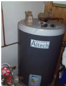
Bereder er plassert på vaskerommet
