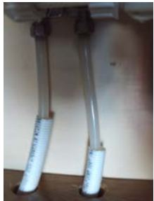
Vannrør i kjøkkenbenken uten muffe.
