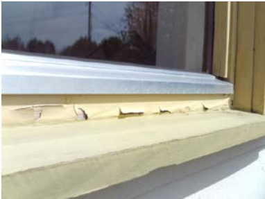
Noe vedlikehold må beregnes på utvendig karm og ramme.
