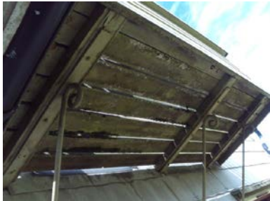
Luftbalkong er slitt.
