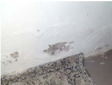
Maling løsner på grunn av fuktighet i grunnmur.
