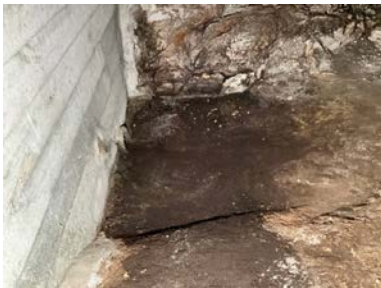
Noe fukt helt ved inngangen
