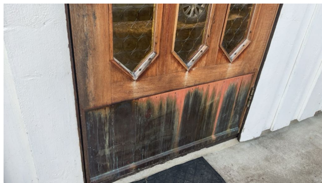
Ytterdør er slitt der utskifting bør vurderes
