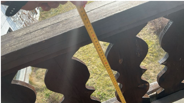
Høyde rekkverk under krav
