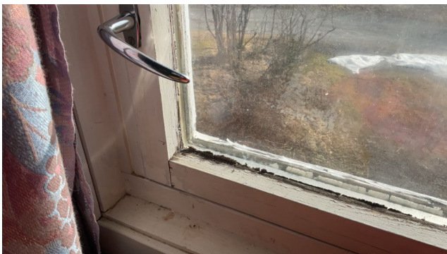
Må påregnes utskifting av vinduer
