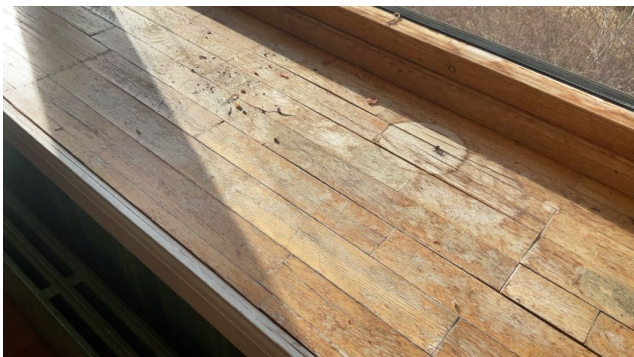
Slitasje i karm
