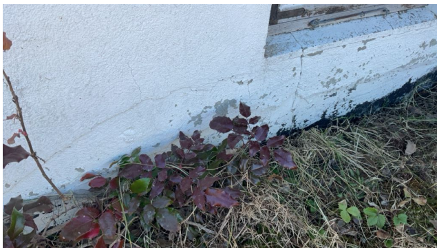
Sprekker i yttermur
