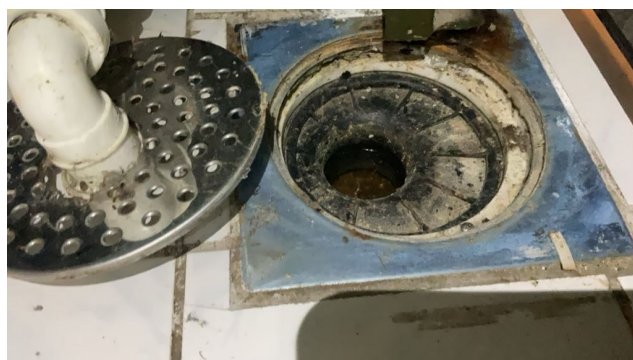
Fra sluk var det ikke synlig membran eller tettesjikt
