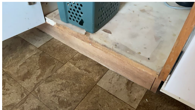
Slitasje på innredning, fuktpreget plate under oppvaskkum
