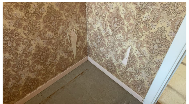
Må foretas oppussing/renovering av enkelte rom/overflater
