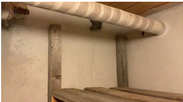
Sprekker i mur
