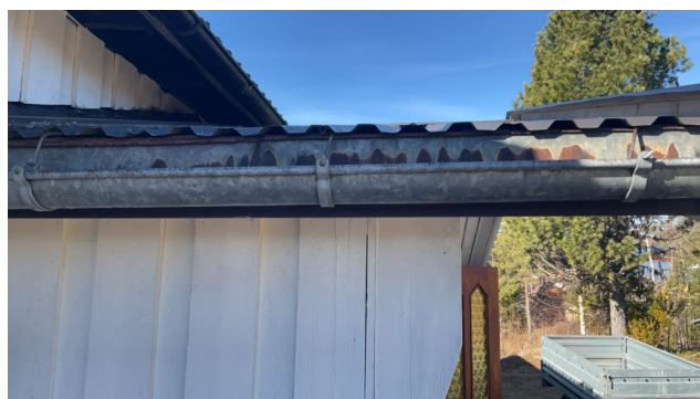
Rust på renner/forkantbeslag ved inngang
