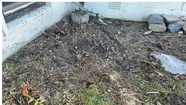
Flatt og ikke helning fra grunnmur, kan forårsake fukt mot mur og vannansamling
