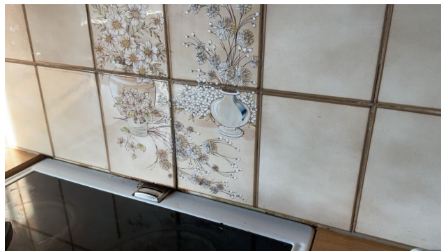
Sprekker i fuger/fliser
