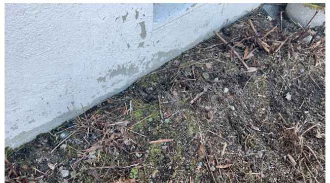
Ingen synlig drenering på opprinnelig del
