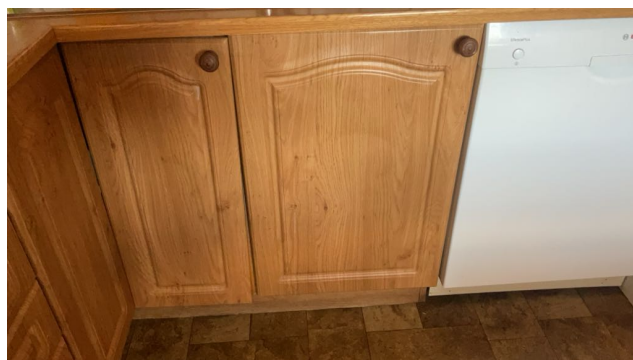
Skjevheter i dører
