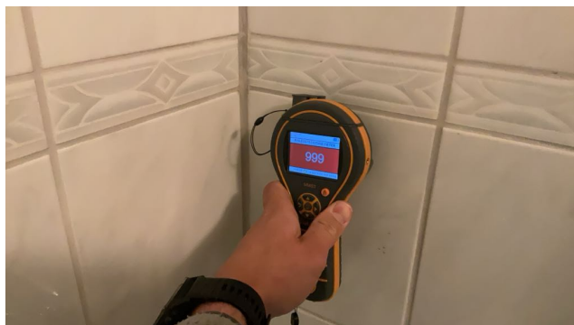
Ved overflatesøk av egnet fuktutstyr var det fuktutslag på vegg i dusj
