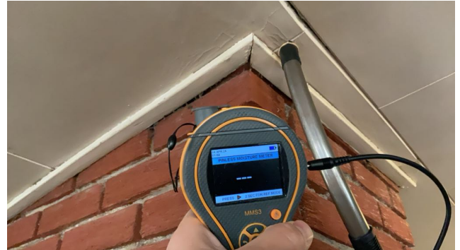
Fuktpreget himling ved pipe, ved fuktmåletaking var det ikke utslag, men årsakssammenheng er avvik fra kryploft
