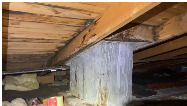
Fuktskader i takkonstruksjon ved pipestamme
