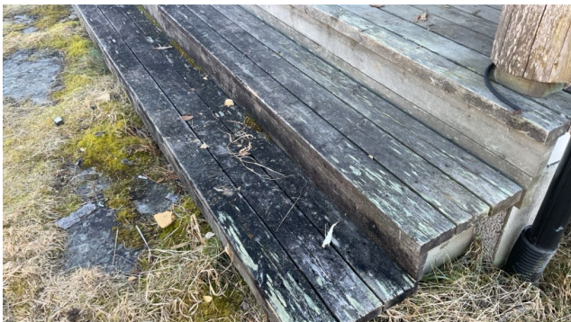
Slitasje der deler av konstruksjon må skiftes
