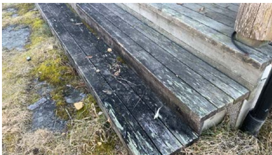
Slitasje der deler av konstruksjon må skiftes
