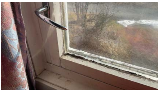
Må påregnes utskifting av vinduer
