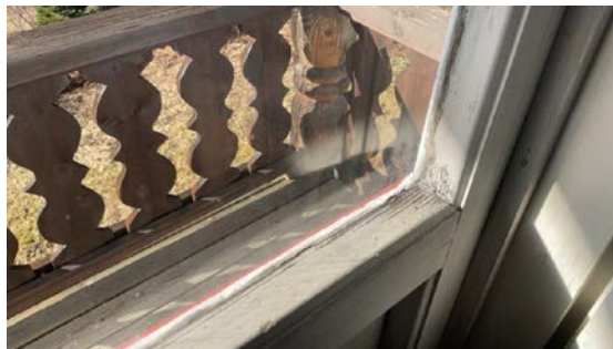
Bør påregnes oppgradering/utskifting av terrassedører.
