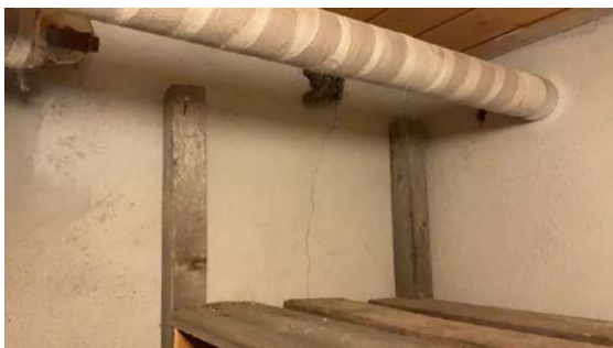
Sprekker i mur
