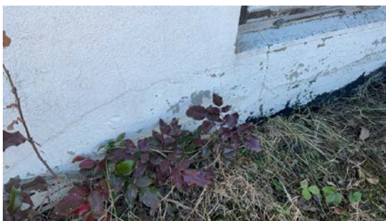
Sprekker i yttermur
