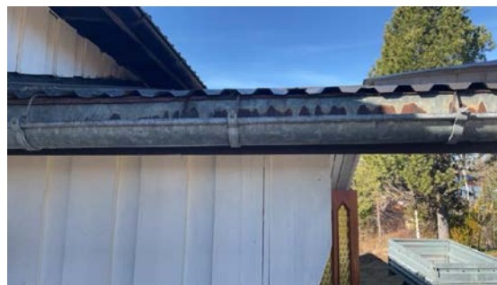
Rust på renner/forkantbeslag ved inngang
