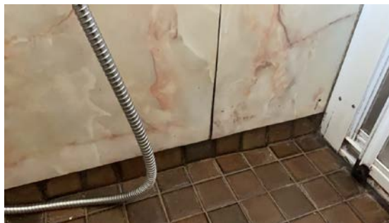
Skader på baderomsplater i dusj
