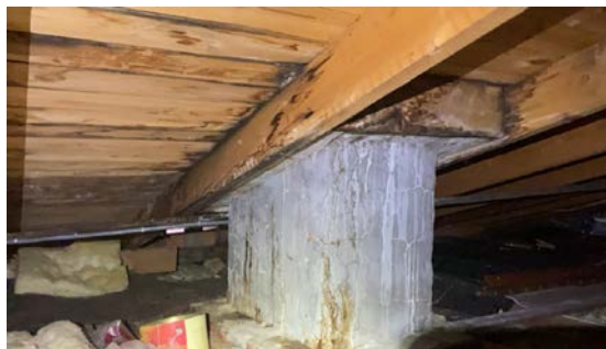
Fuktskader i takkonstruksjon ved pipestamme
