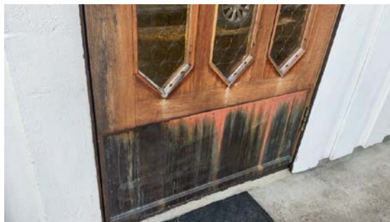
Ytterdør er slitt der utskifting bør vurderes
