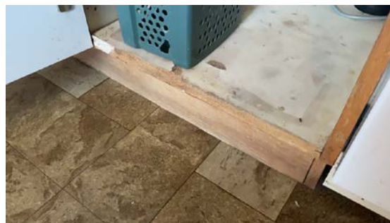
Slitasje på innredning, fuktpreget plate under oppvaskkum
