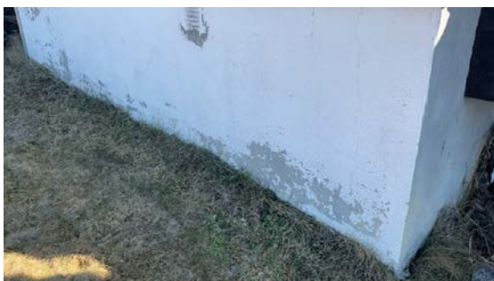
Avflassing av maling
