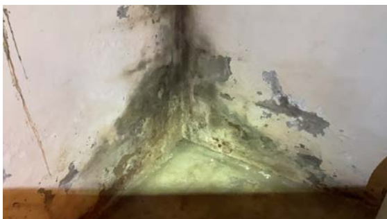
Fuktskjolder med forvitring av betong og saltutslag bemerket i ene boden, må hensyntas avvik/nærmere undersøkelse av andre kjellerrom
