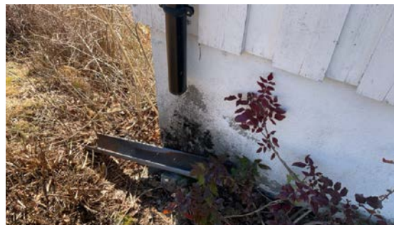
Manglende bortledning av takvann, vil føre til oppfukning av yttermur
