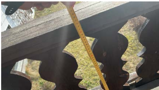
Høyde rekkverk under krav
