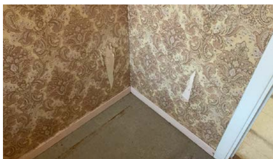
Må foretas oppussing/renovering av enkelte rom/overflater
