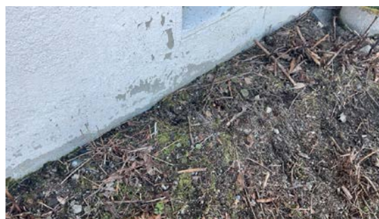
Ingen synlig drenering på opprinnelig del
