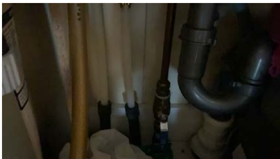
Hovedstoppekran er plassert i kjøkkenbenken.
