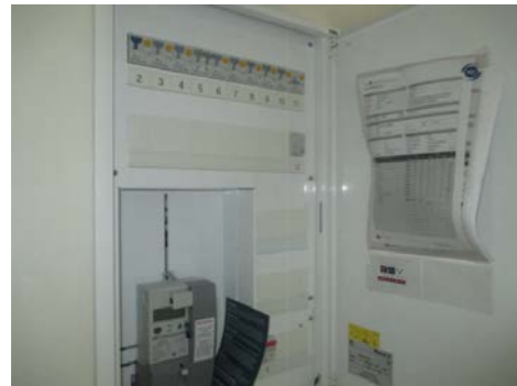
Sikringskapet er plassert i gangen av leiligheten.
