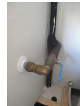
Innvendig stoppekran i et skap på hotellrom.
