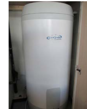
Bereder er plassert i et skap på hotellrom.
