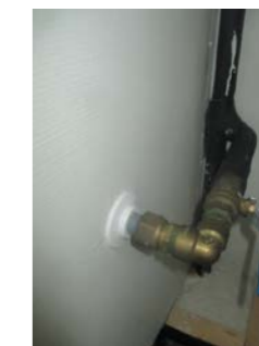
Innvendig stoppekran i et skap på hotellrom.
