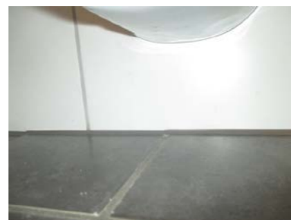
Ingen hull for synliggjøring av lekkasjevann.
