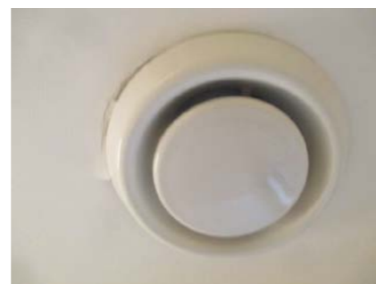
Avtrekk i himling.
