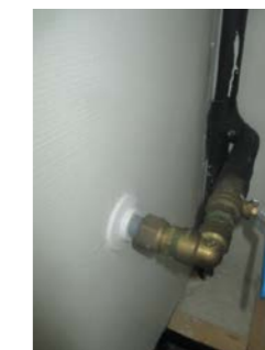
Innvendig stoppekran i et skap på hotellrom.
