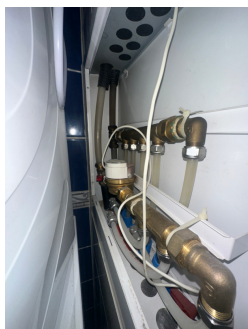
Samleskap med rørkurser og stoppekraner på bad.
