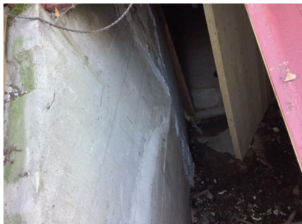
Murt/støpt nedgang til kjeller har deformasjon etter jordtrykk/teleskader.
