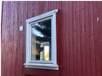
Ufagmessig omramming. Det mangler beslag over vinduer.
