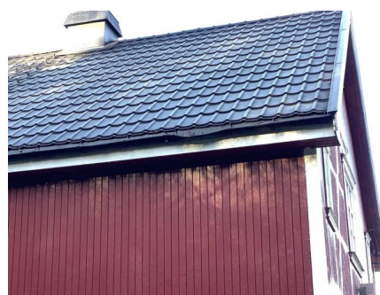
Bulk i renne etter takras.
