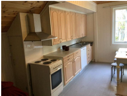
Overskap er montert noe lavt mot benkeplate ift anbefalt høyde.
