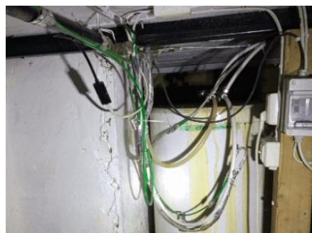
Manglende klamring av vannrør.
