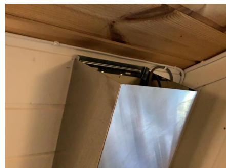
Anbefaler kanal ut på vegg fra ventilator.
