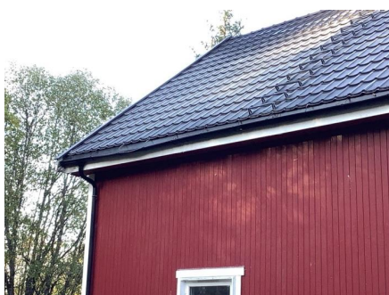
Bulk i renne etter takras.
