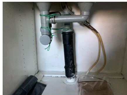
Eldre vann og avløpsrør i benk. Anbefaler sjekk av årsak til at avløpsrør som er knyttet sammen i benk.
