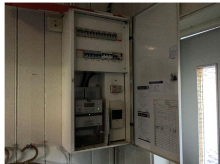
El- skap med automatsikringer. Kursfortegnelse bør oppdateres.
