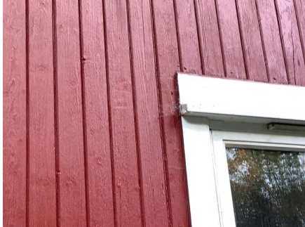
Ufagmessig omramming. Det mangler beslag over vinduer.
