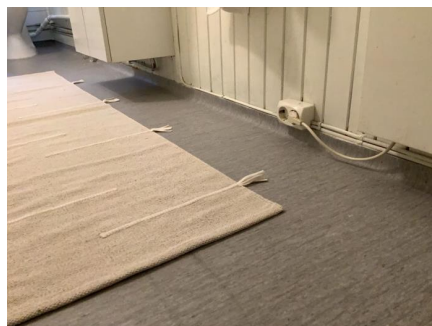
Ikke egnet materiale på vegg i våtsone. Uheldig plassering av stikkontakt. Anbefaler sjekk av fagmann.
