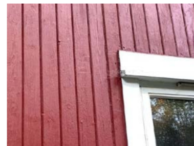
Ufagmessig omramming. Det mangler beslag over vinduer.
