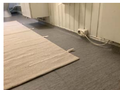
Ikke egnet materiale på vegg i våtsone. Uheldig plassering av stikkontakt. Anbefaler sjekk av fagmann.
