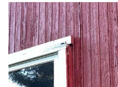
Ufagmessig omramming. Det er registrert råteskader i omramming.
