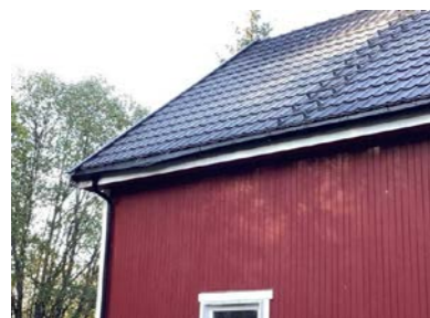
Bulk i renne etter takras.
