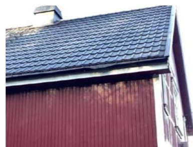
Bulk i renne etter takras.
