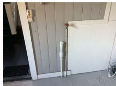
Det er opplegg for vaskemaskin på kjøkken.
