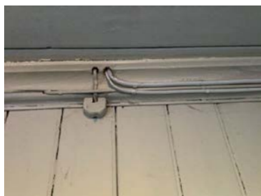
Det er el-anlegg av varierende alder i boligen.
