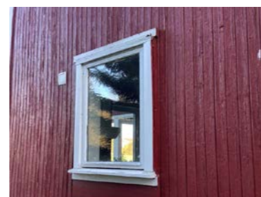
Ufagmessig omramming. Det mangler beslag over vinduer.
