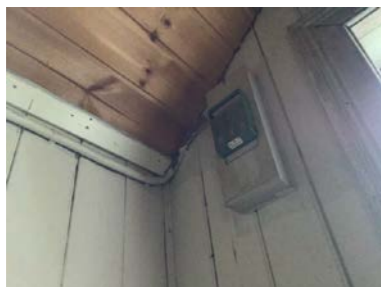
Inntakssikring er plassert i trappegang.
