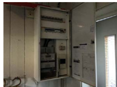
El-skap med automatsikringer. Kursfortegnelse bør oppdateres.
