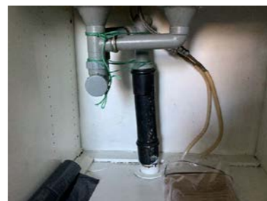
Eldre vann og avløpsrør i benk. Anbefaler sjekk av årsak til at avløpsrør som er knyttet sammen i benk.
