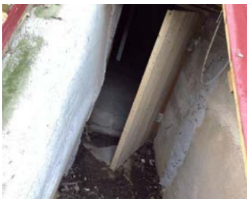
Dør til kjeller kan ikke åpnes helt. Murer og trapp har deformasjon.
