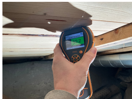
10,2 på andre befaring.
