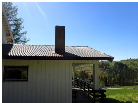
Manglende stige på tak for feier.
