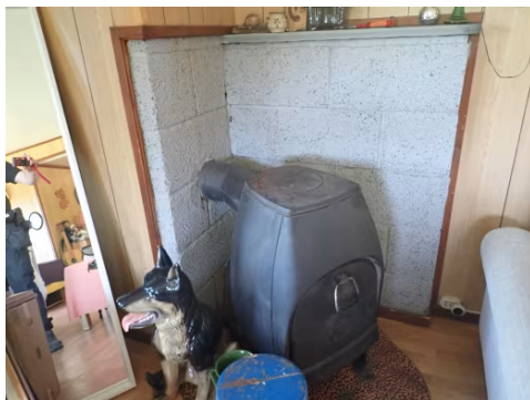
Vedovn i 1. etasje. Innkledd pipe.
