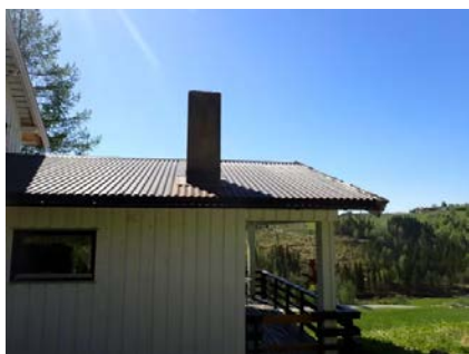
Manglende stige på tak for feier.
