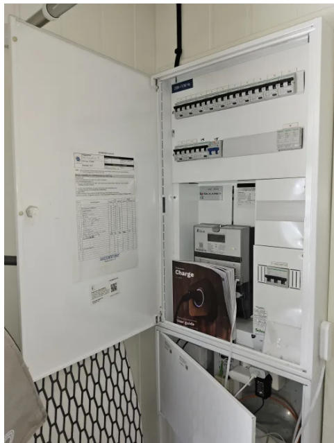
Bilde viser sikringsskap.
