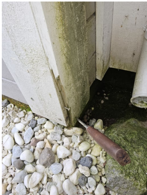
Bilde viser råteskadet hjørnebord.
