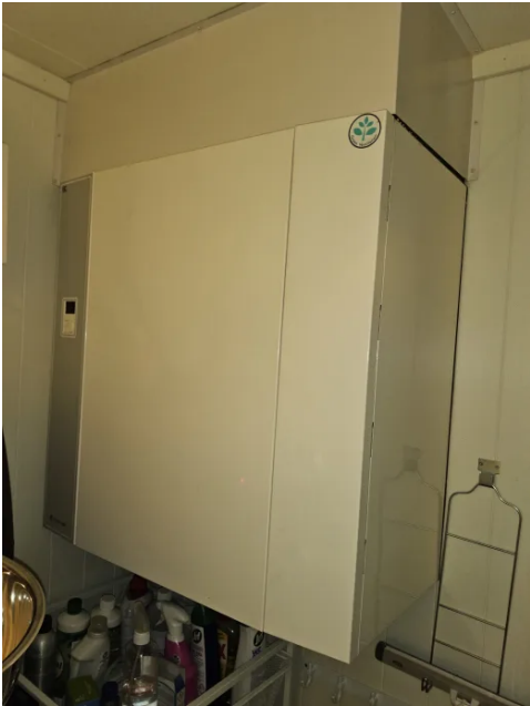
Bilde viser ventilasjonsaggregat.
