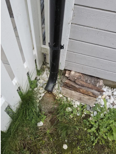
Bilde viser taknedløp avsluttet over bakken.
