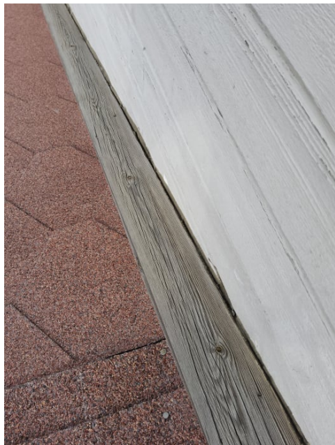
Bilde viser mangelfull overgang mellom tak over vinterhage og yttervegg.
