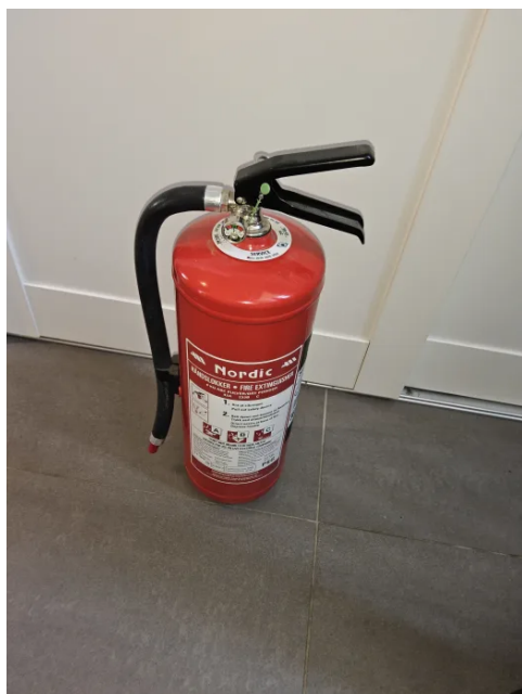
Bilde viser brannslukningsapparat.
