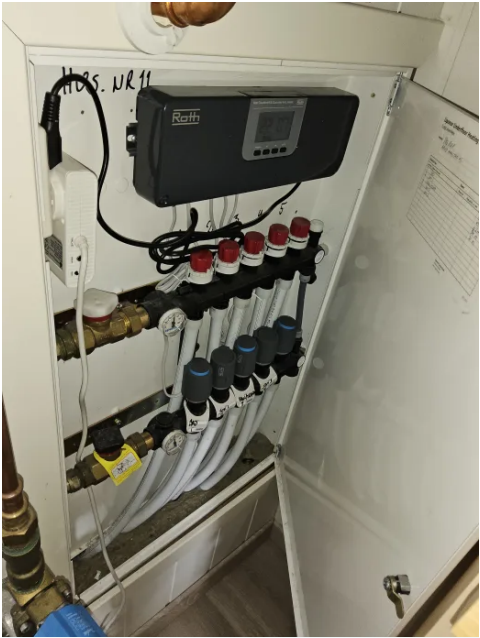
Bilde viser fordelerskap for vannbåren gulvvarme.
