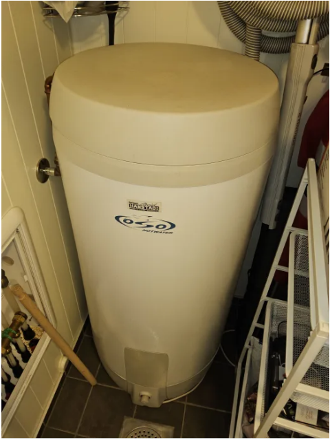
Bilde viser varmtvannsbereder.
