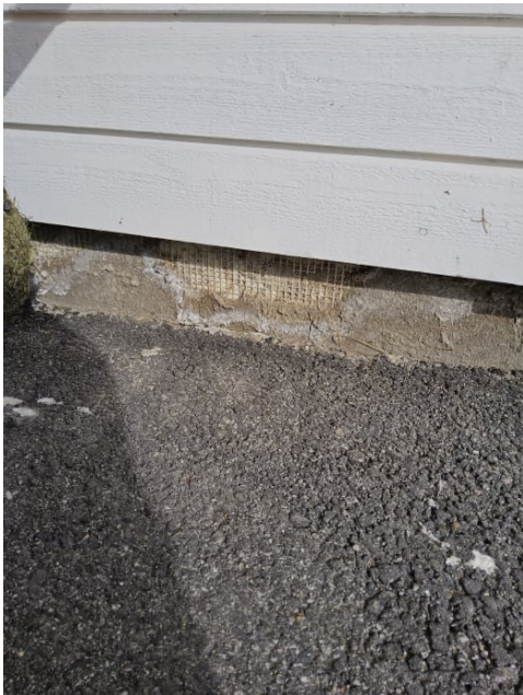
Bilde viser manglende puss på grunnmuren.
