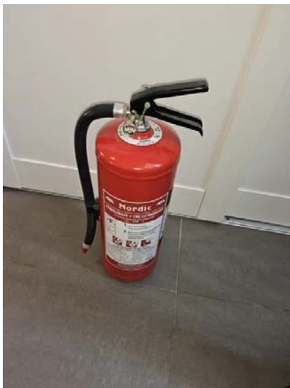
Bilde viser brannslukningsapparat.
