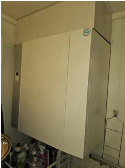
Bilde viser ventilasjonsaggregat.
