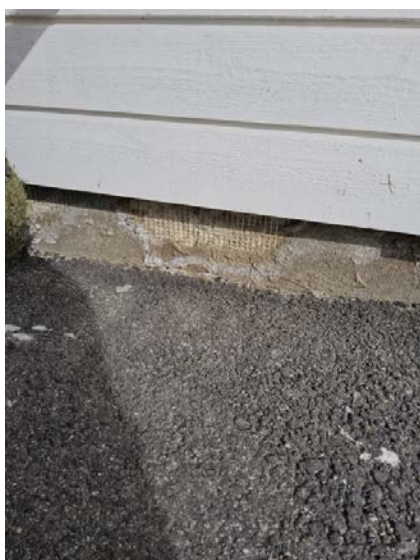
Bilde viser manglende puss på grunnmuren.
