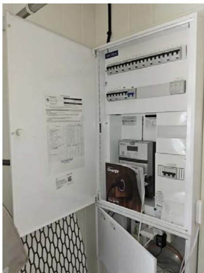
Bilde viser sikringsskap.
