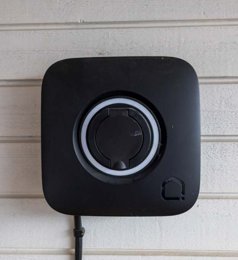
Elbil-lader ble installert av Innlandet Elektro AS i 2024.
