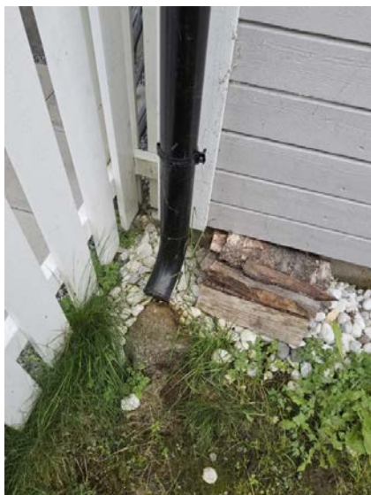
Bilde viser taknedløp avsluttet over bakken.
