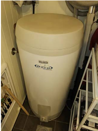
Bilde viser varmtvannsbereder.
