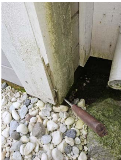
Bilde viser råteskadet hjørnebord.
