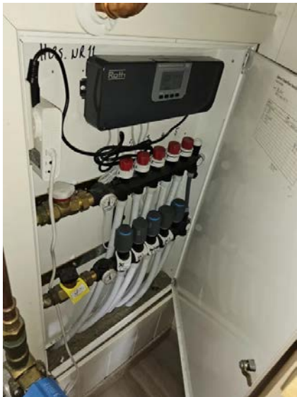
Bilde viser fordelerskap for vannbåren gulvvarme.
