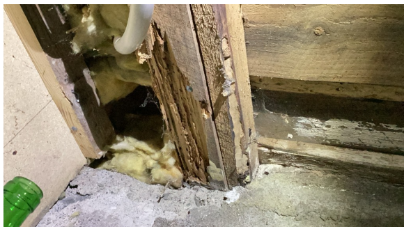
Spredte råteskader observert.
