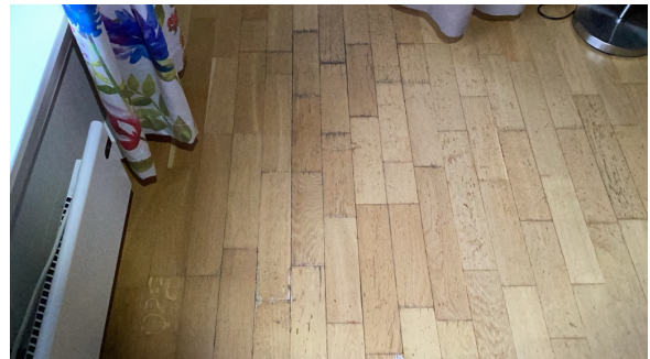
Misfarging på gulv enkelte steder.
