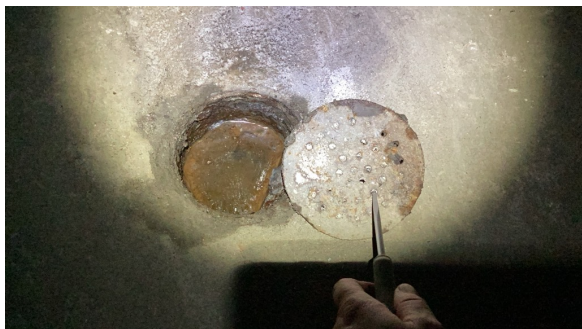
Rust i sluk på bod.
