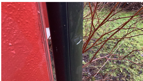
Bulk på nedløp.
