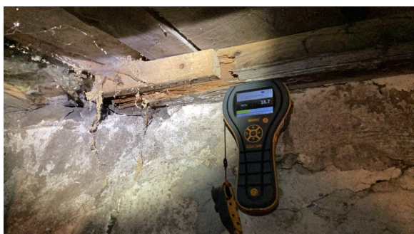
Ved enkel fuktmåling registrerte jeg fukt.
