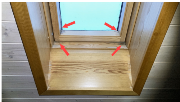
Fuktmerker på takvindu.
