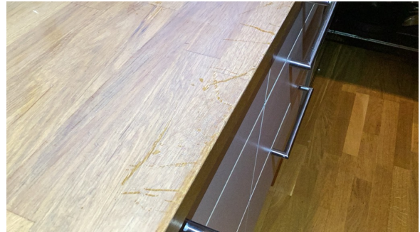
Riper i benkeplate.
