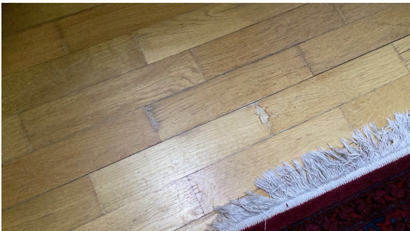
Misfarging på gulv enkelte steder.
