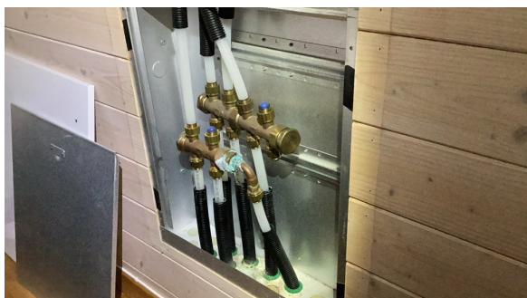
Fordelerskap på soverom.
