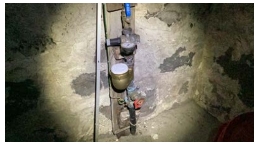
Stoppekran på bod i kjeller.
