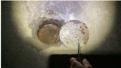
Rust i sluk på bod.
