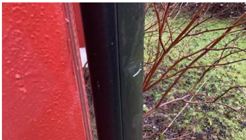
Bulke på nedløp.
