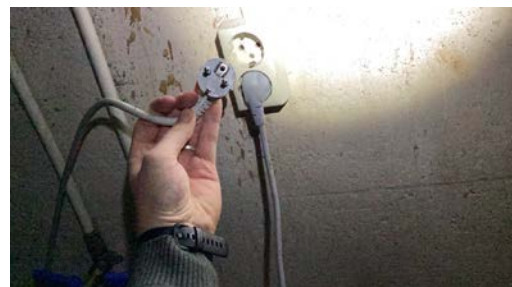
Sjekk av støpsel.
