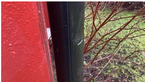
Bulk på nedløp.
