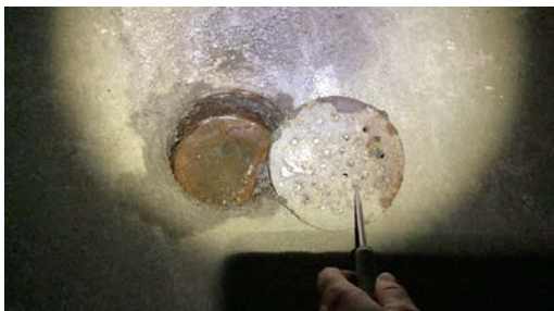
Rust i sluk på bod.
