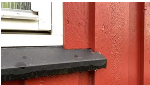
Kledning er ført ned på vannbrett, risiko for fuktopptrekk.
