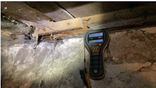
Ved enkel fuktmåling registrerte jeg fukt.
