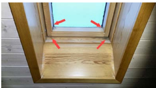
Fuktmerker på takvindu.
