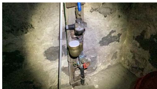
Stoppekran på bod i kjeller.
