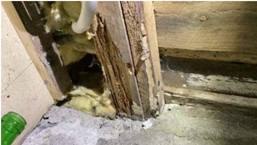
Sprede råteskader observert.
