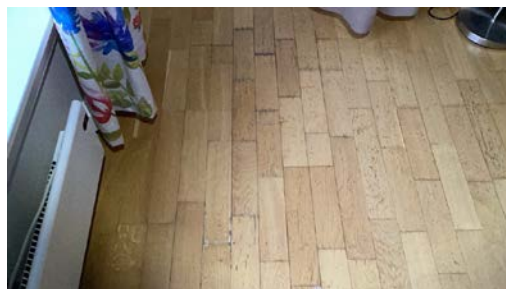
Misfarging på gulv enkelte steder.
