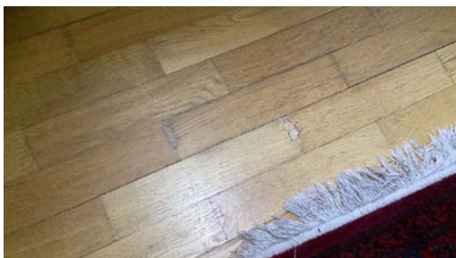
Misfarging på gulv enkelte steder.
