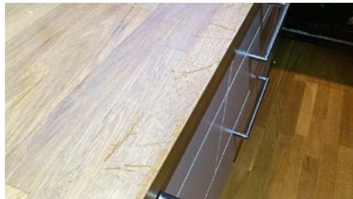
Riper i benkeplate.
