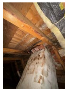
Fuktmåling er ikke utført da det ikke vartilgjengelig høy nok stige/trapp på befaringen. Bilde tatt med telefon fra luke.
