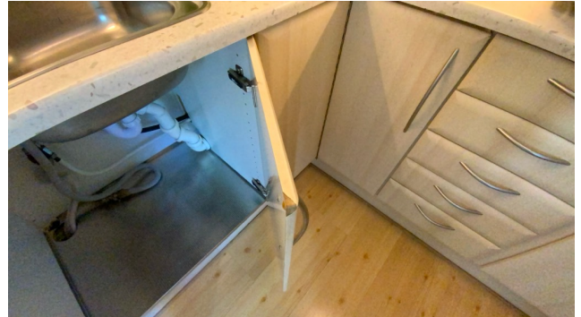
Stedvis synlig slitasje.
