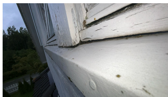
Værslitte vinduer mot vest.
