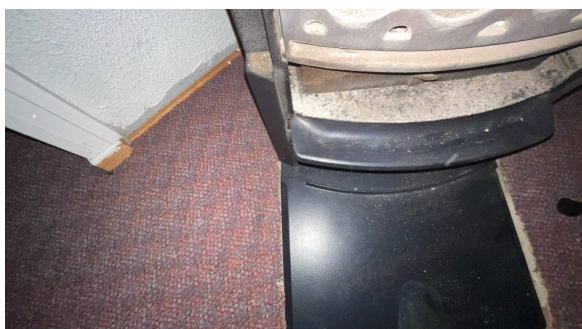
Kort avstand fra ovnsdør til brennbart materiale i kjeller
