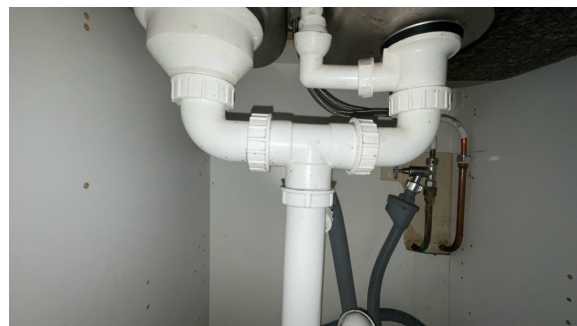
Utetette rørkoblinger under vask.
