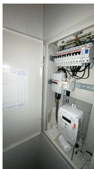
Sikringsskap på hobbyrom i kjeller.
