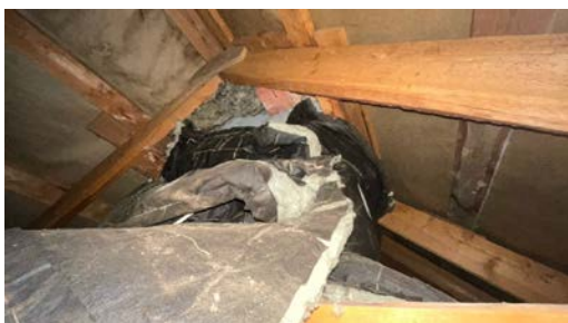
Pipevanger tildekket på kryploft.
