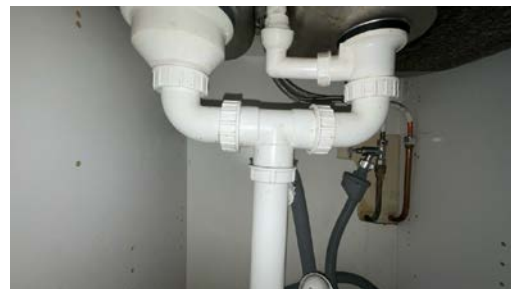
Utette rørkoblinger under vask.
