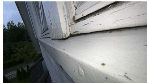
Værslitte vinduer mot vest.
