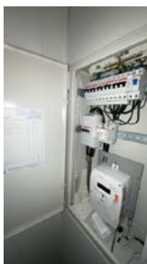
Sikringsskap på hobbyrom i kjeller.
