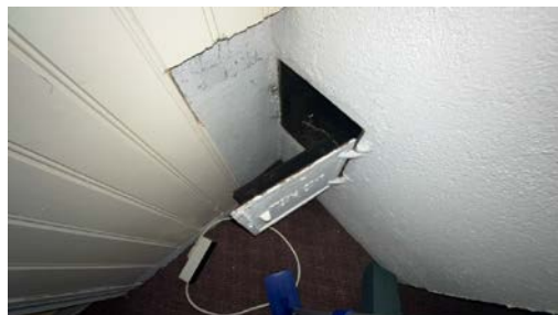
Brennbart materiale nærmere enn 30cm fra feieluke.
