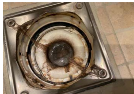
Delvis synlig mansjett i sluk. (lite bad)
