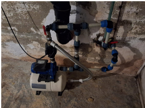
Vnnpumpe arbeider mye grunnet lekkasje på vannrør
