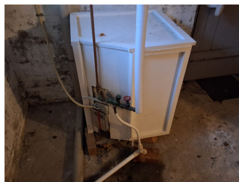
Varmtvannbereder er innebygget
