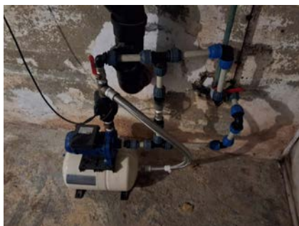
Vannpumpe arbeider mye grunnet lekkasje på vannrør
