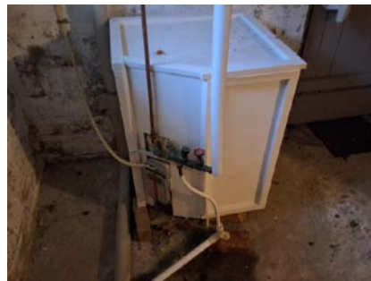
Varmtvannbereder er innebygget
