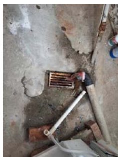
Her er det en lekkasje på vannrør eller tank
