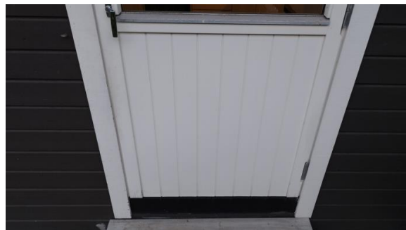
-Litt oppsprukket maling på terrassedøren.
