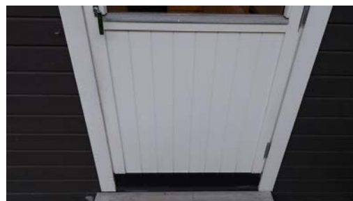
-Litt oppsprukket maling på terrassedøren.
