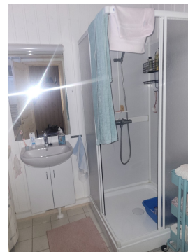
Vegger ved kabinett og servant bør fuktbeskyttes.
