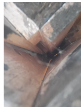
Manglende musesperre under hjørnebord
