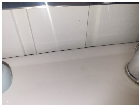
Vegg bak servant bør fuktbeskyttes.
