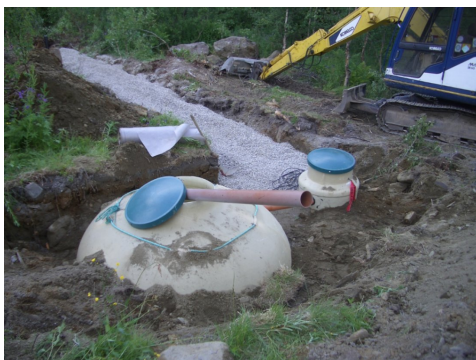
Septiktank, pumpekumme og spredegrøft.
