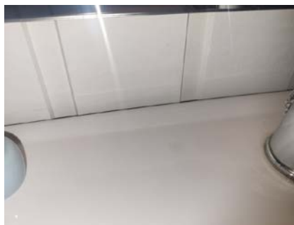
Vegg bak servant bør fuktbeskyttes.
