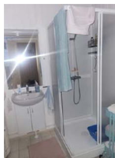
Vegger ved kabinett og servant bør fuktbeskyttes.
