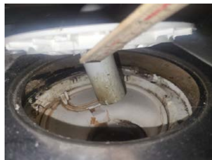
Plastsluk i gulv.
