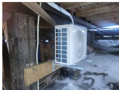
Varmepumpe montert i 2024.
