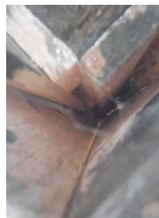
Manglende musesperre under hjørnebord
