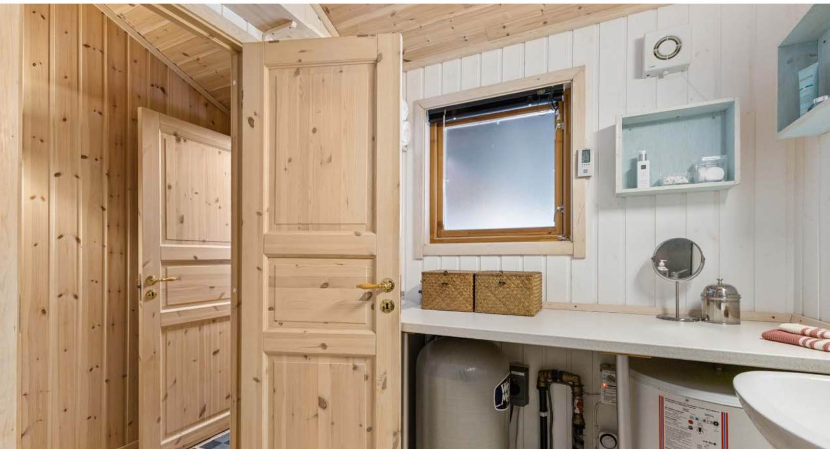
Varmtvannstank fra 1995 er plassert på badet.
