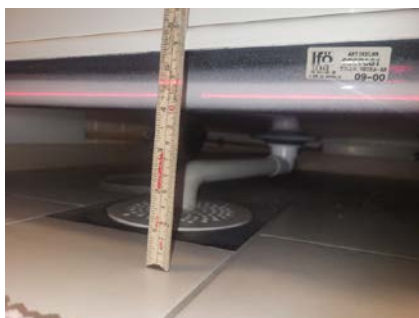
Måling av fall til sluk.
