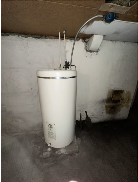
Viser bereder plassert i kjeller.
