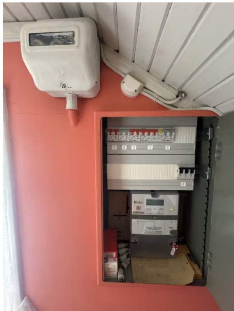
Viser inntak og sikringsskap plassert i 2. etasje
