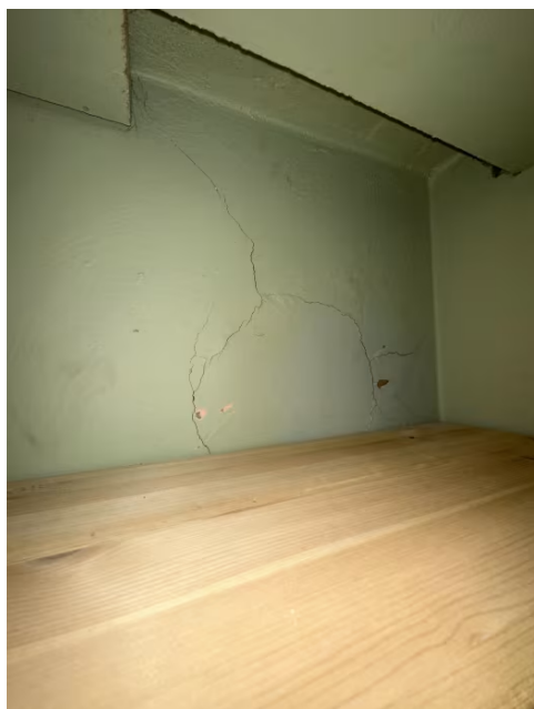
Der registreres sprekk og avskalling på pipe.
