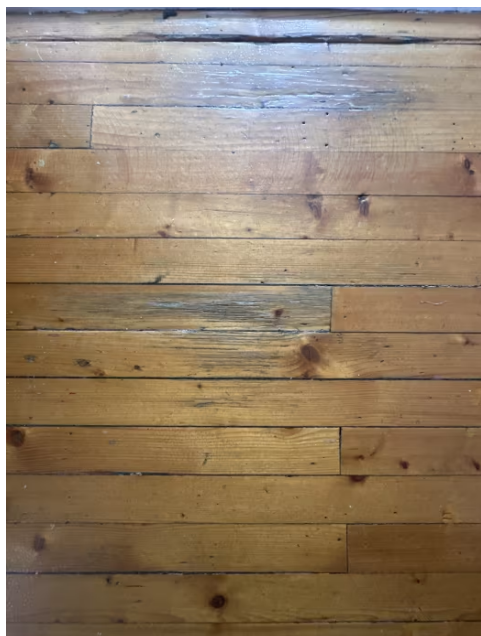
Viser slitasje på gulv.
