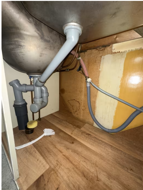
Viser vann og avløpsinnstallasjoner under kum.
