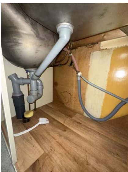
Viser vann og avløpsinnstallasjoner under kum.
