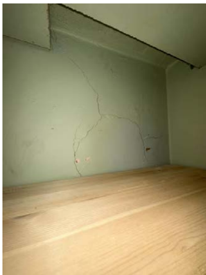
Der registreres sprekke og avskalling på pipe.
