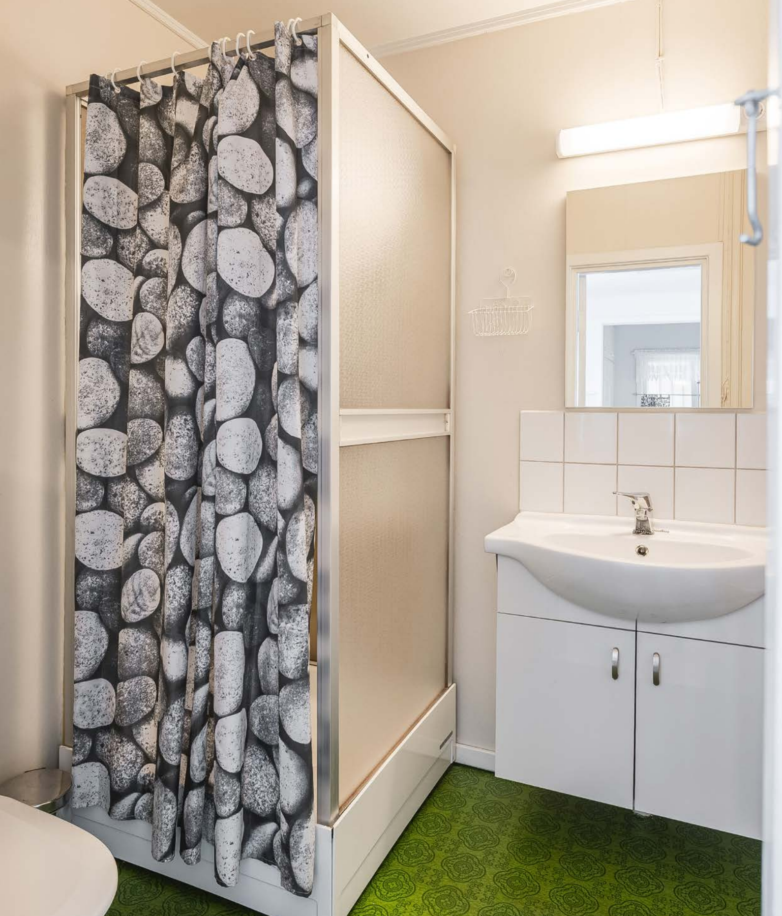
Eldre baderom som har fått TG3 i tilstandsrapporten. Det er behov for totalrenovering av våtrommet!
