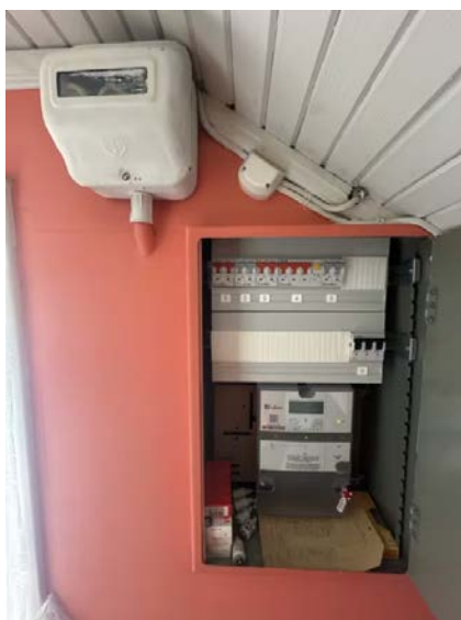
Viser inntak og sikringsskap plassert i 2. etasje
