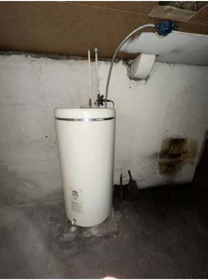
Viser bereder plassert i kjeller.
