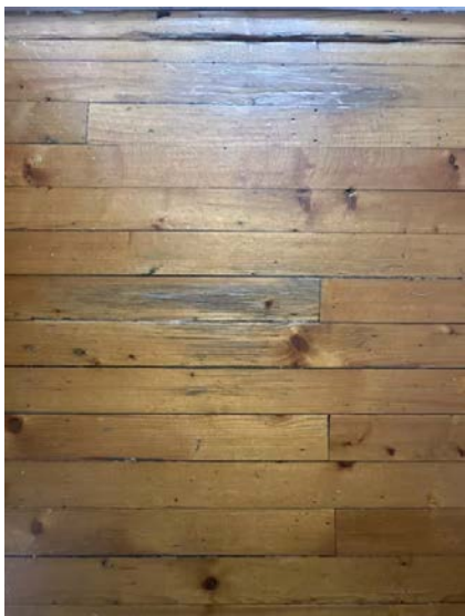
Viser slitasje på gulv.
