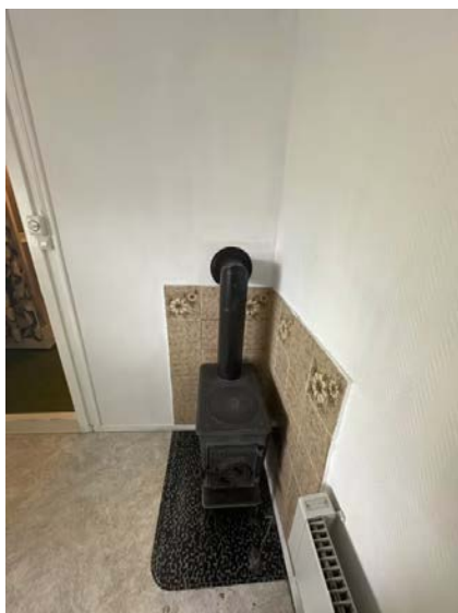
Vedovn plassert på kjøkkenet.
