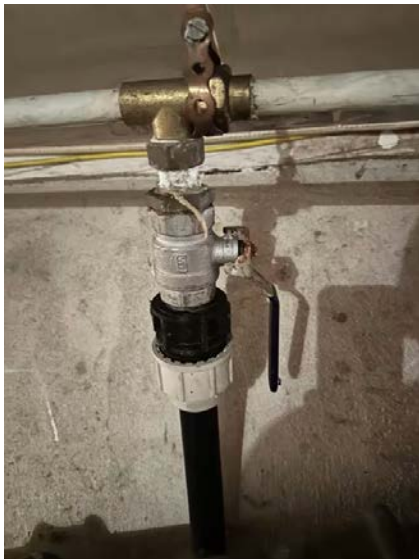
Viser hovedstoppekran og vanninntak.
