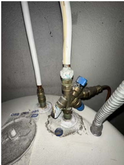
Det registreres irr og rust på koblinger. Antydninger til lekkasje.
