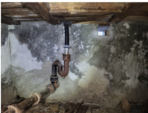
Avløp av plast og soilrør.
