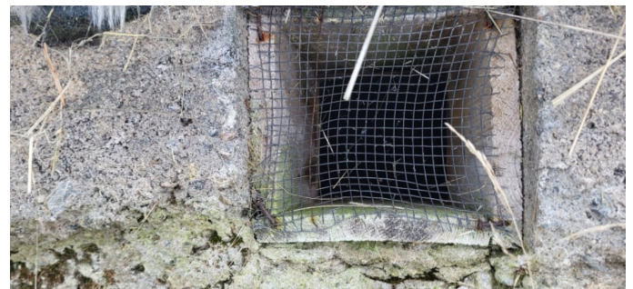
Netting foran ventil mot kryprom som ikke kan inspiseres
