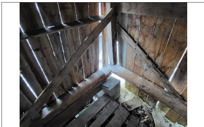
Hjørneknute på vegg i uthus er løsnet.
