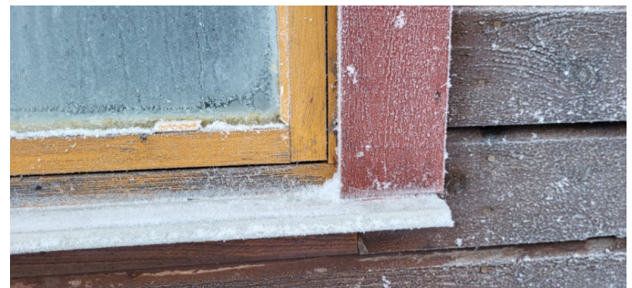
Kitt på vinduer er løsnet.
