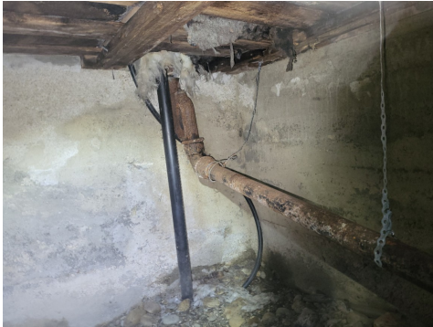
Vann og avløpsledninger.
