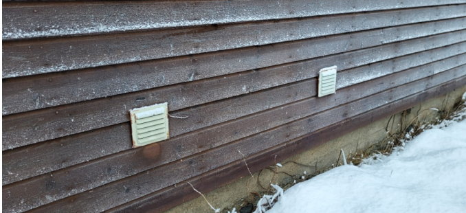
Veggventiler fra tørkerom.
