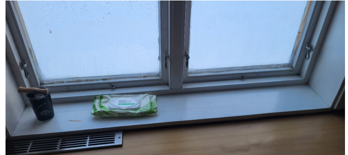
Kondens/ råteskader i karmen.
