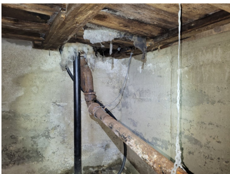
Avløp av plast og soilrør.
