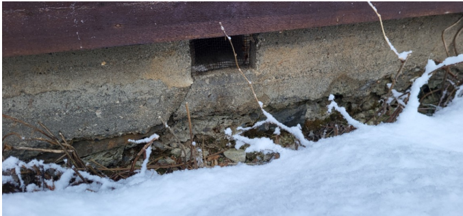
Sprekk i grunnmur.
