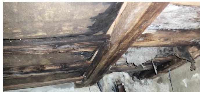
Råteskader i treverk.
