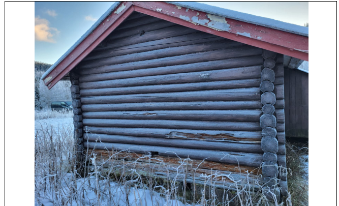
Råteskadet tømmervegg på uthus.
