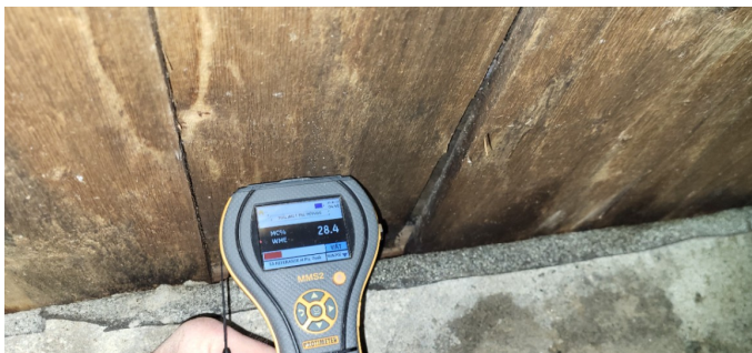
Påvist fukt i tregulv.
