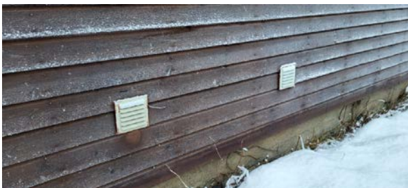
Veggventiler fra tørkerom.
