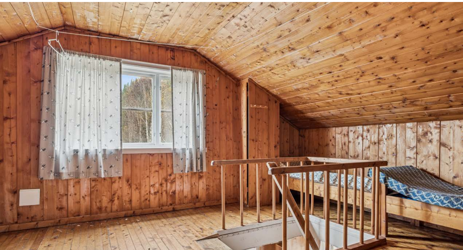
Loftsetasjen har synlig skråtak med trepanel, og gulvet viser tegn til slitasje.
