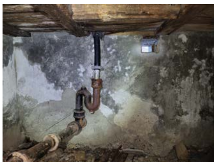
Avløp av plast og soilrør.
