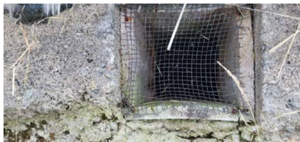
Netting foran ventil mot kryprom som ikke kan inspiseres
