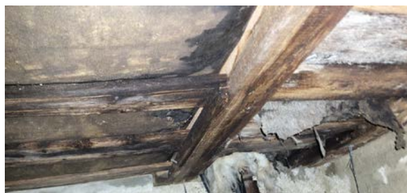
Råteskader i treverk.
