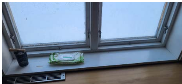
Kondens/ råteskader i karmen.
