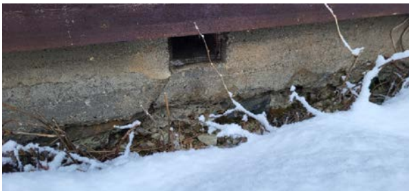
Sprekk i grunnmur.
