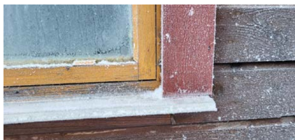
Kitt på vinduer er løsnet.
