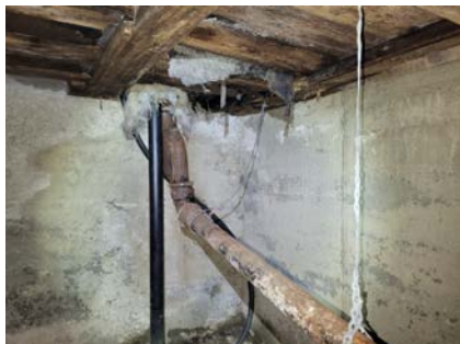
Avløp av plast og soilrør.
