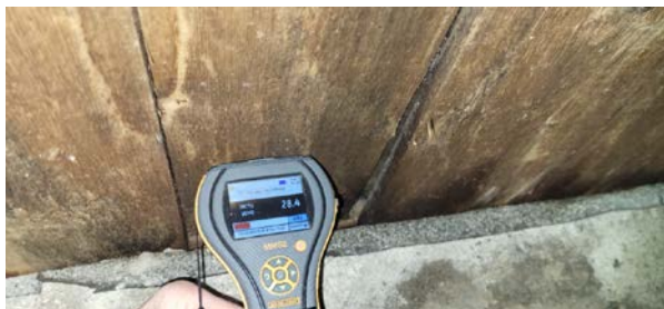
Påvist fukt i tregulv.
