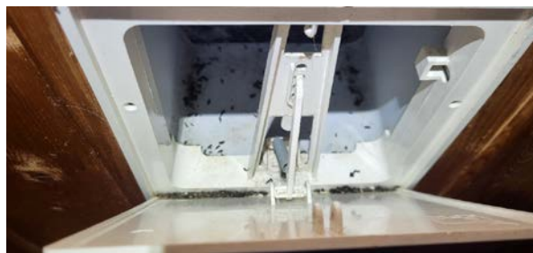
Spor av mus innvendig i veggventiler.
