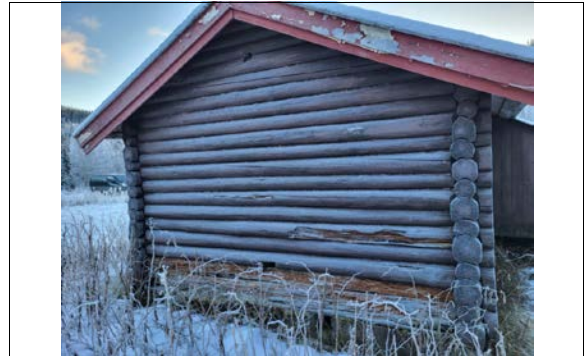
Råteskadet tømmervegg på uthus.
