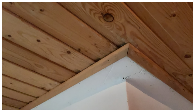
Registrert fuktskjold ved pipestamme
