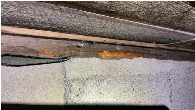
Registrert stedvis røte i enkelte bunnsviller mot grunnmur, nærliggende kapitalrøpssug fra grunnmur og fukt i kryprom,
