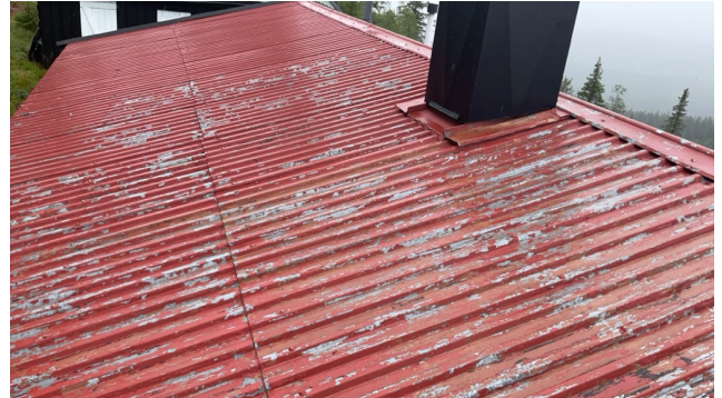
Avflassing og slitasje på tekking
