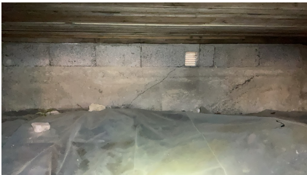
Sprekk i grunnmur
