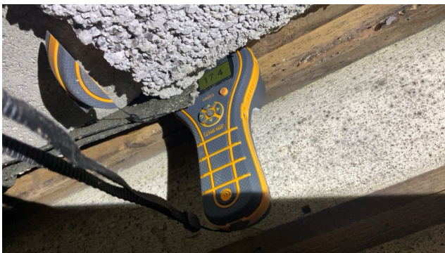
Ved fuktmåletaking var det fuktsutslag over normalt fuktnivå noe som gir grunn til overvåking og tiltaksbehov vurderes
