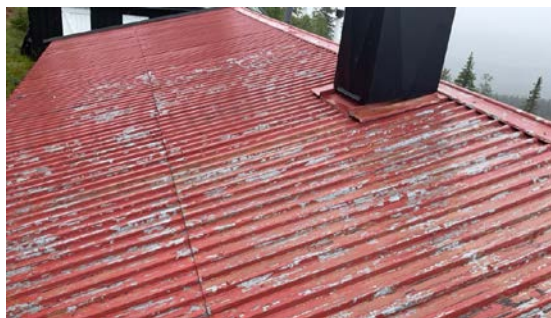
Avflassing og slitasje på tekking
