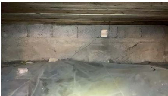
Sprekk i grunnmur
