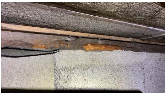
Registrert stedvis råde i enkelte bunnsviller mot grunnmur, nærliggende kapitalærøpsug fra grunnmur og fukt i kryprom,
