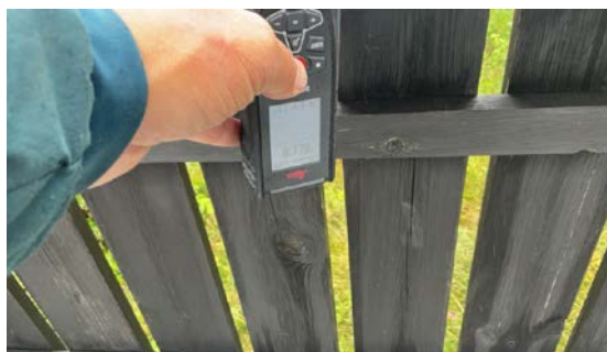
Rekkverkshøyde er under krav til høyde da høyde til terreng er over 0,5 m
