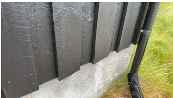
Bemerket kuling av enkelte kledningsbord, spesielt mot solvendt vegg
