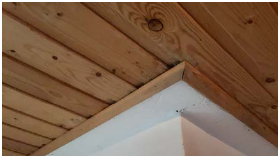
Registrert fuktskjold ved pipestamme
