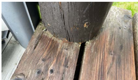
Råte i endevend på søyler.
