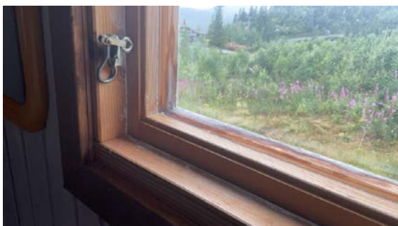
Bemerket slitasje, nærliggende kondensering som årsak
