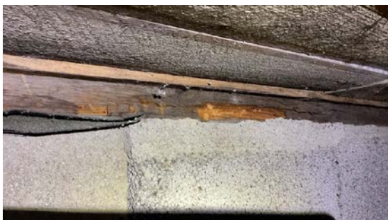
Registrert stedvis røte i enkelte bunnsviller mot grunnmur, nærliggende kapitalærøpsug fra grunnmur og fukt i kryprom,
