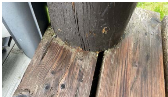
Råte i endevend på søyler.
