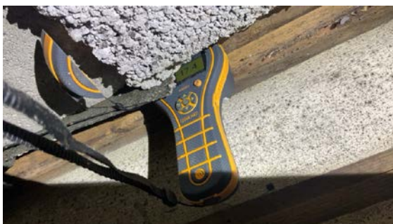
Ved fuktmåletaking var det fuktsutslag over normalt fuktinnhold noe som gir grunn til overvåking og tiltaksbehov vurderes
