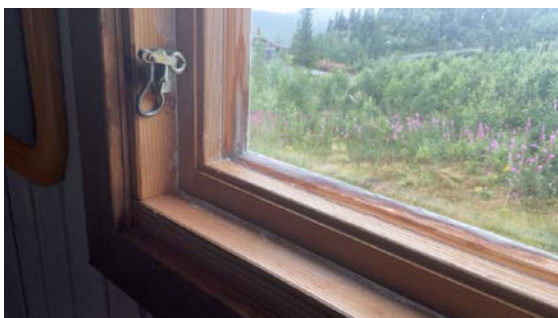
Bemerket slitasje, nærliggende kondensering som årsak
