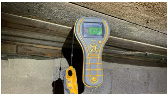
Ved fuktmåletaking av stubbeloft var det normal fuktinnhold under befaring
