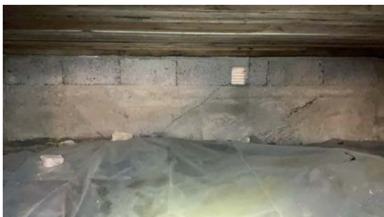
Sprekk i grunnmur
