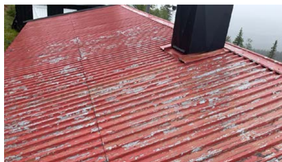
Avflassing og slitasje på teking
