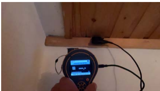
Ved fuktmåletaking er var det ikke fuktutslag ved befaringstidspunkt
