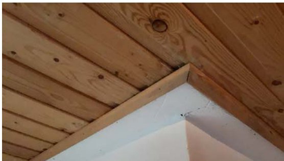
Registrert fuktskjold ved pipestamme
