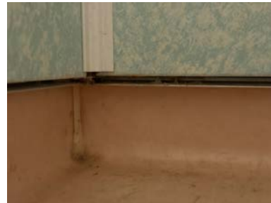
Det er ikke etablert silkonfuge i overgang bunnskinne/ våtromsplater
