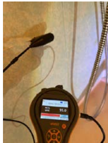
Skade på våtromsplate i dusjonen.
