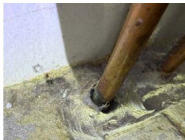
Kun fuget med silikon og stedvis åpninger
