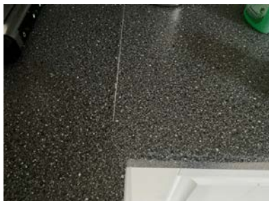
Fuktskade i benkeplaten.
