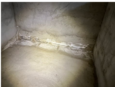
Saltutslag på gulv/vegg.
