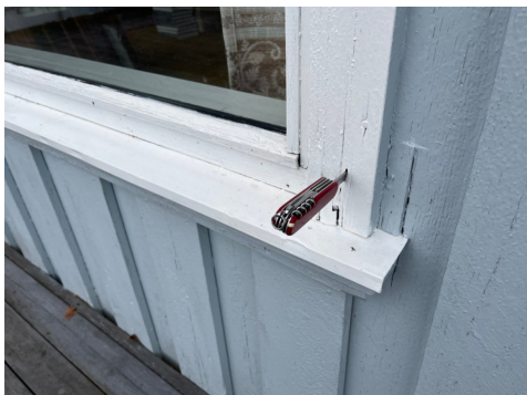
Utvendig omramming på vinduer må gås over og utbedres.
