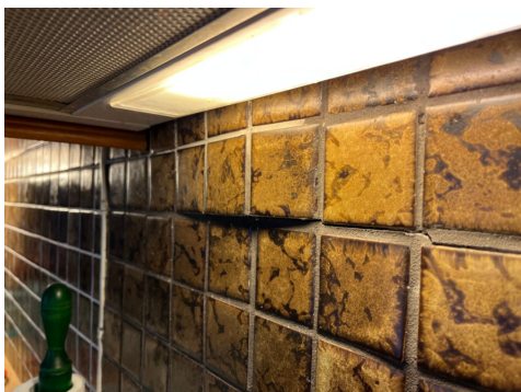
Fliser på vegg over kjøkkenbenk har løsnet.
