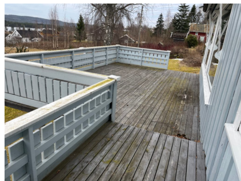
Veranda/balkong har manglende vedlikehold.
