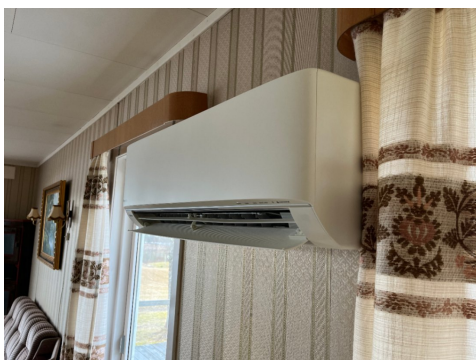
Varmepumpe i stue.
