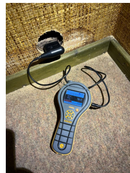
Fuktmåling i vegg, viste skadelig fukt.
