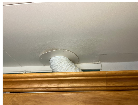
Fuktskadet himling ved gjennomføring av kanal.
