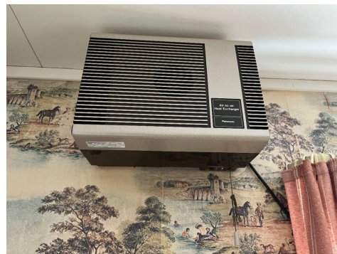
Varmepumpe i soverom.
