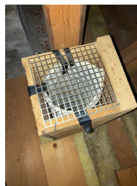
Avtrekkskanal fra kjøkken er avsluttet på loft.
