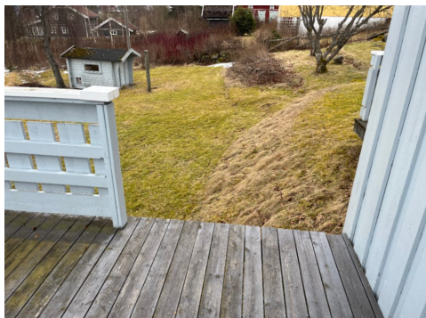
Veranda har manglende rekkverk.
