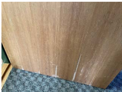
Dør med skadet finer.
