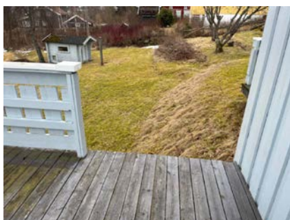
Veranda har manglende rekkverk.
