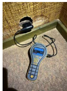
Fuktmåling i vegg, viste skadelig fukt.
