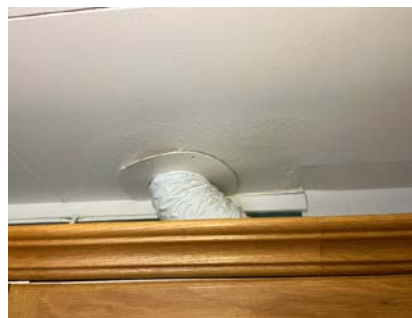
Fuktskadet himling ved gjennomføring av kanal.
