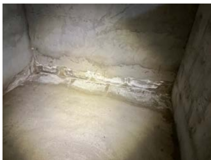
Saltutslag på gulv/vegg.
