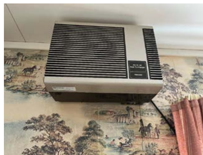
Varmepumpe i soverom.
