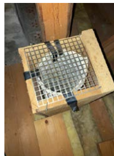
Avtrekkskanal fra kjøkken er avsluttet på loft.
