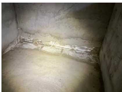
Saltutslag på gulv/vegg.
