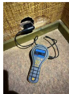
Fuktmåling i vegg, viste skadelig fukt.
