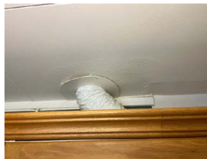
Fuktskadet himling ved gjennomføring av kanal.
