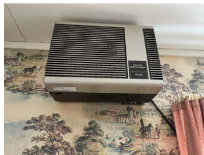
Varmepumpe i soverom.
