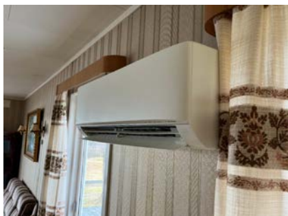
Varmepumpe i stue.
