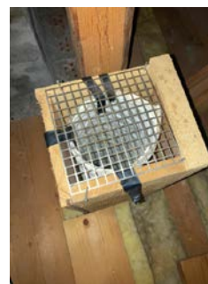
Avtrekkskanal fra kjøkken er avsluttet på loft.
