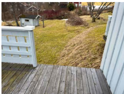
Veranda har manglende rekkverk.
