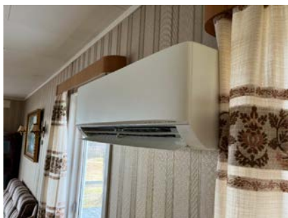
Varmepumpe i stue.
