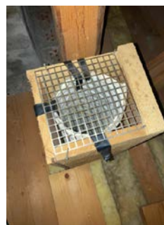
Avtrekkskanal fra kjøkken er avsluttet på loft.
