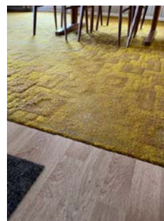
Nedslitte vegg-til-vegg tepper.
