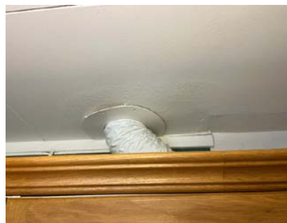
Fuktskadet himling ved gjennomføring av kanal.
