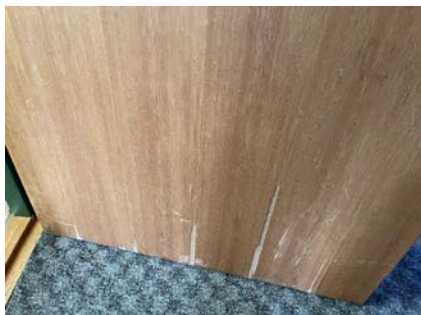
Dør med skadet finer.
