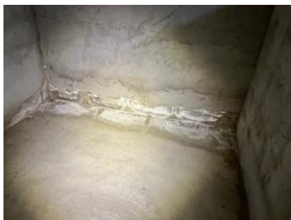
Saltutslag på gulv/vegg.
