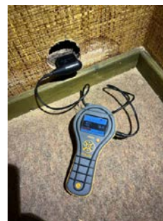
Fuktmåling i vegg, viste skadelig fukt.
