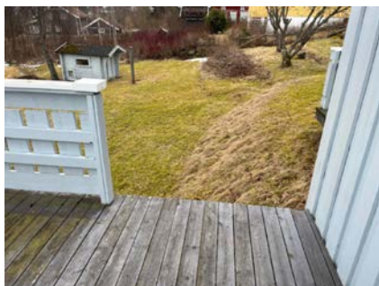
Veranda har manglende rekkverk.
