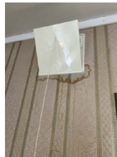
Fuktmerker på vegger, som her ved en veggventil.
