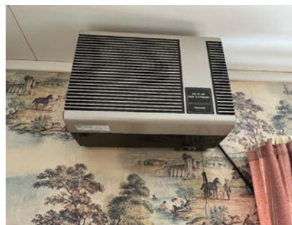
Varmepumpe i soverom.
